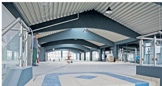
Verwaltung und Geschäftsführung werden im Obergeschoss untergebracht. Deren Großraumbüro ist über die künftige Pausen-Lounge (Bild) erreichbar.
